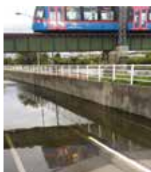
実際に冠水が起こった箇所(射水市二の丸町 地内)
